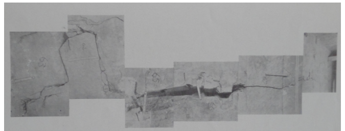
図3 サンタ・マリア・デル・フィオーレ大聖堂のクーポラの亀裂
